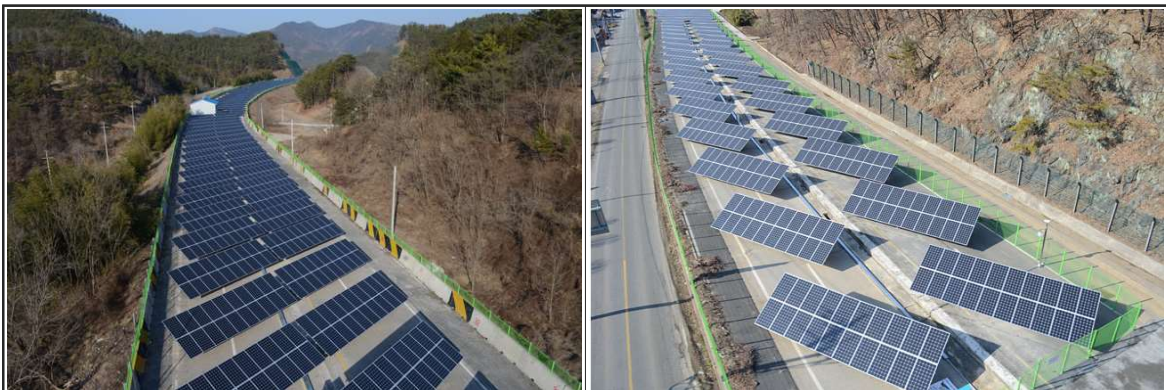
태양광발전 : 남해고속도로 폐도구간 설치
